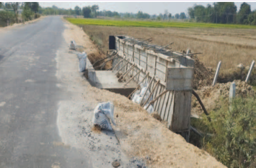
ఉప్పునుంతల, గట్టుకాడిపల్లి మార్గంలో నాసిరకంగా చేపడుతున్న కల్వర్లు నిర్మాణ పనులు
